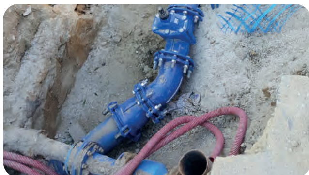
Patrimoine réseaux eau potable
