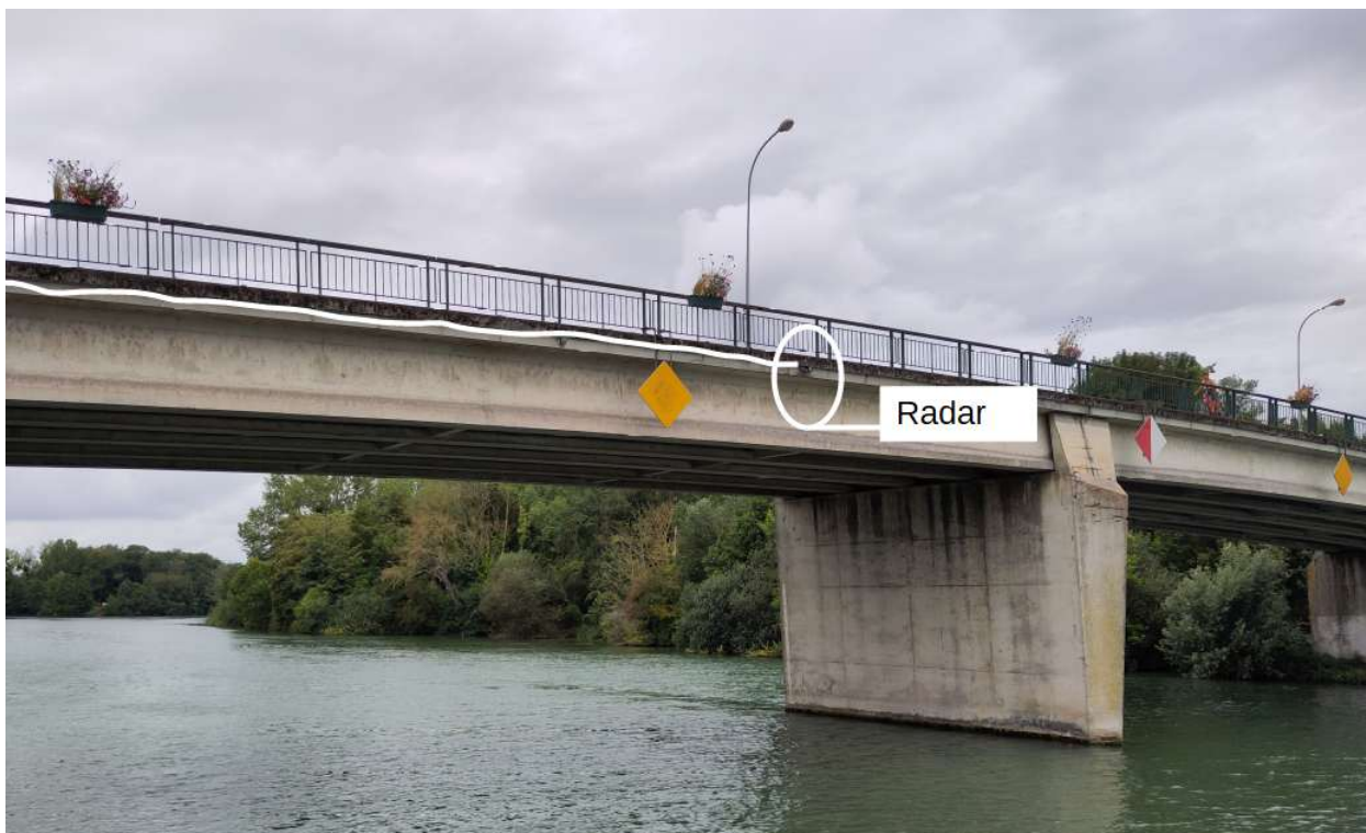
Vue vers l'aval, position du radar sous le pont
